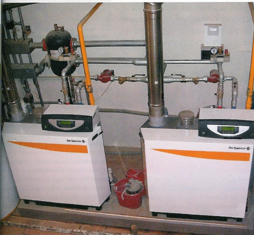
РИС. 2 Два конденсационных котла C210-170 в каскаде. Котельная для загородной резиденции, поставка: «РВСКЛИМАТ ТЕРМО»
