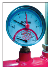
Термоманометр на выходе котла
